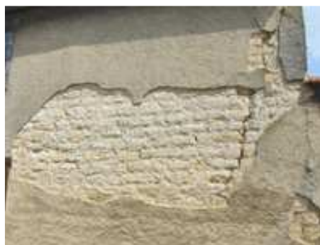
Mur en moellons assisés en mauvais état, Chamery
