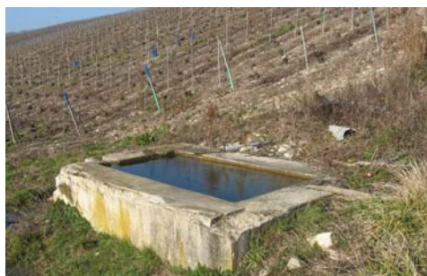
Bassin en ciment servant à recueillir l'eau de pluie pour les travaux de sulfatage, Vincelles
