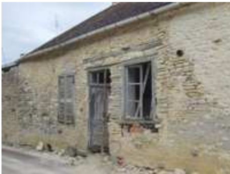
Maison élémentaire en déshérence avec portes et fenêtres ruinées. Le clos n'est plus assuré ni contre les intempéries et l'humidité, ni contre le vandalisme. Chervey
