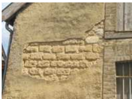
Enduit en mauvais état mettant les pierres gélives à nu, Villers-Marmery
